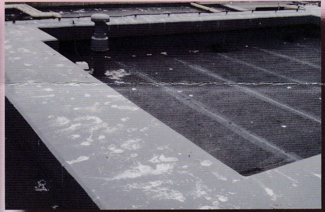
【フンによる屋上の汚れ】
